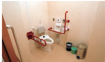
改修を機に、完全に分離された女子トイレ。赤い手すりと小ぶりの便器がかわいらしい。
