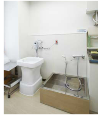
整形外科にある処置室には、汚物流しを設備。右側は、患者さんの足を洗える脚洗器。
