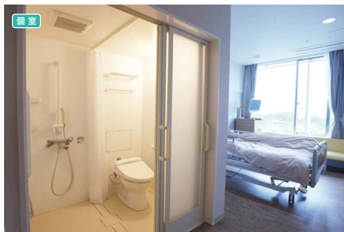
病棟個室のトイレ・シャワーユニット。急性期医療が中心であるため、特別室以外には浴槽を設けずシャワーのみとしている。
