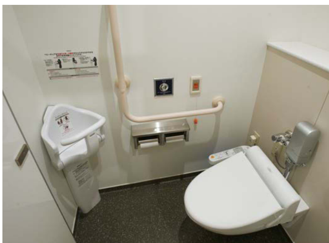
2F外来の女性用トイレでも、壁掛け大便器などを採用。ベビーチェアが設けられている。
