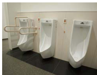
2F外来の男性用トイレでは、清掃のしやすい壁掛け小便器を採用している。
