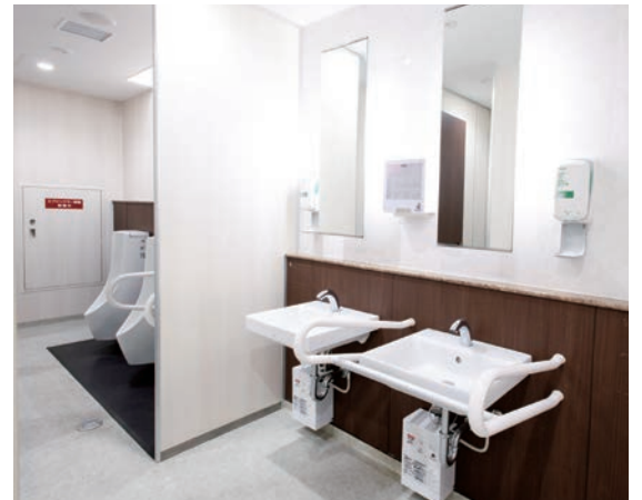
中央診療棟5Fの男性用トイレ。自動洗浄小便器や自動水栓など、非接触の設備を採用。また冬場でも快適に使えるよう、小型電気温水器も設置されている。
