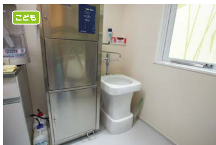
小児病棟に設けられたサニテーション室。トルネード洗浄の汚物流しが設置されている。
