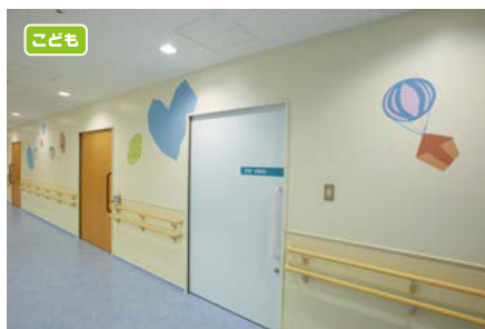
廊下の手すりは上下2本で、誰にでも使いやすい。明るい色で意匠性の高い腰壁は、ストレッチャーガードも兼ねている。
