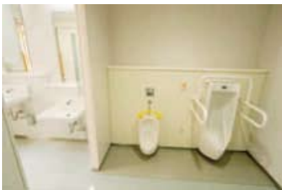
小児科の集中トイレには子ども用便器が完備された。手すりが付いた小便器のほか、洋便器も男女ともに子ども専用の小さなものが、低めのパーティションとともに設置された。
