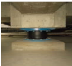
病棟、中央診療棟、外来棟、ホスピタルモールには免震構造を採用。
