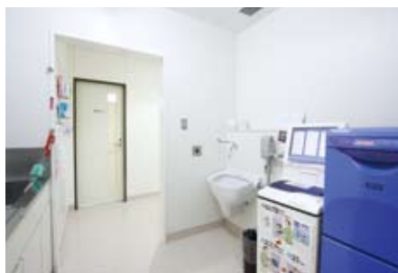
汚物室には、コンパクトで水はねの少ない汚物流しを設置。尿が見えず臭いの問題を解消する蓄尿器も置かれている。左奥が検尿用トイレ。
