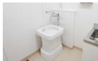
一つの病棟に必ず一つの汚物室を設け、レバーハンドルで水はねの少ない新型の汚物流しを導入している。
