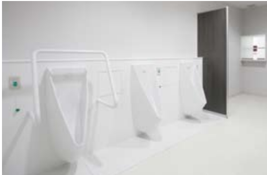
1F外来の男性用トイレ。小便器はすっきりとしたデザインで、専用の手すりも形状にこだわっている。清掃のしやすさも大きな特徴である。
