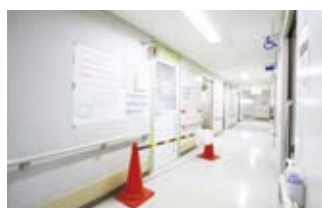
工事中の廊下。スピーディーな工事のため、使えない期間はごくわずかである。
