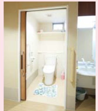
トイレの左右に型手すりが設置されている。
