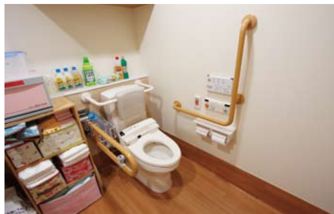
共用部のトイレでは、L型手すりや跳ね上げ手すり、背もたれなどを採用している。
