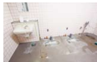
工事中のトイレ内部。床も新しく張り替えたが、壁面はそのまま残している。
