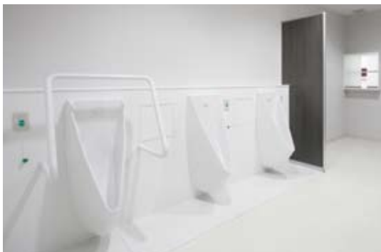
1F外来の男性用トイレ。小便器はすっきりとしたデザインで、専用の手すりも形状にこだわっている。清掃のしやすさも大きな特徴である。
