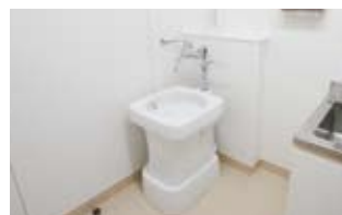
一つの病棟に必ず一つの汚物室を設け、レバーハンドルで水はねの少ない新型の汚物流しを導入している。
