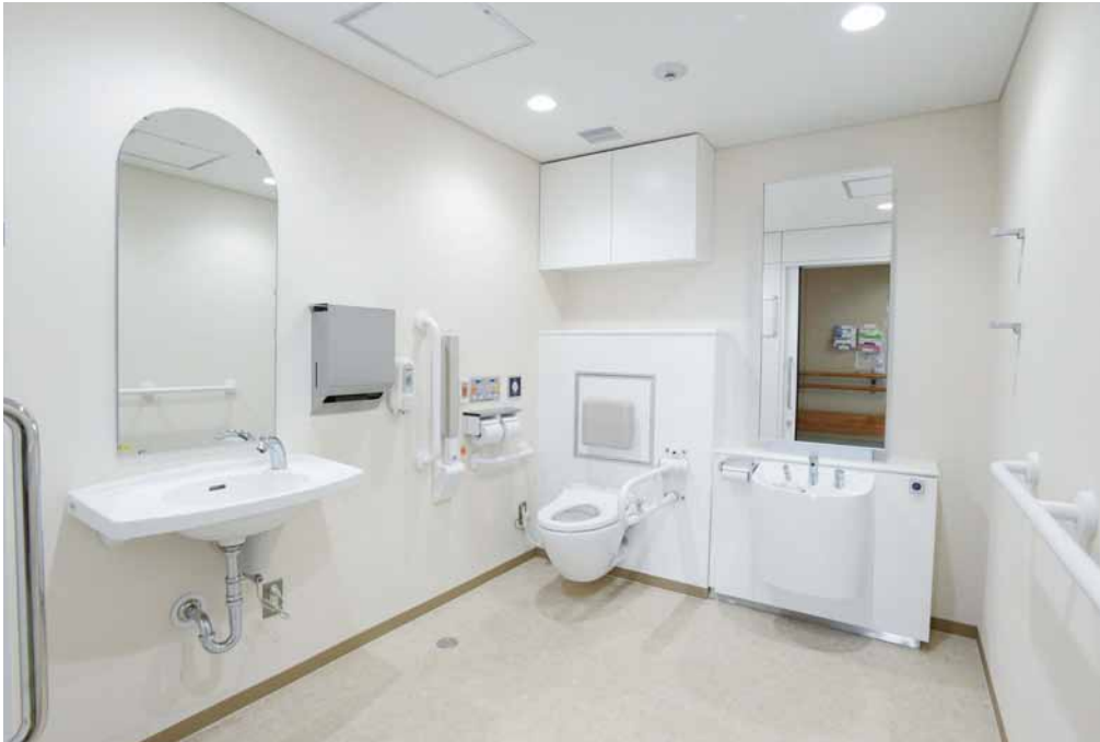
病棟10F(外科病棟)の、オストメイト対応の車いすトイレ。壁面にも手すりを設けるなど、いろいろな身体状況の患者さんの使いやすさと安全性を考慮している。
