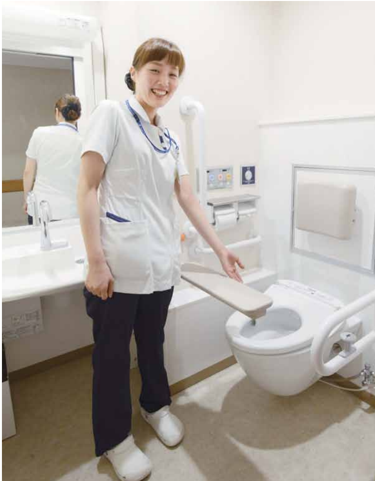
整形外科などが入っている、病棟9Fの個室のトイレ。背もたれ、跳ね上げ手すり、I型手すり、前方アームレストが備えられ、大便器は壁掛けタイプを採用。
