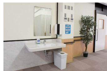
一般居室の廊下に設けられた手洗器。車いす利用者も奥までアプローチできて、使いやすい。
