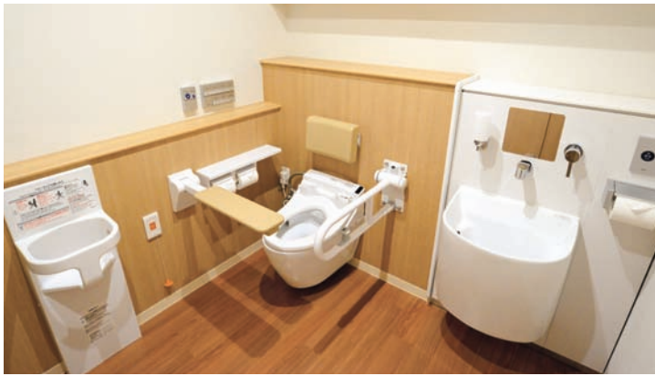
1Fの多機能トイレには、前方ボード、はね上げ手すり、背もたれなどを設置。ペビーチェアやオストメイト対応器具も備えられている。
