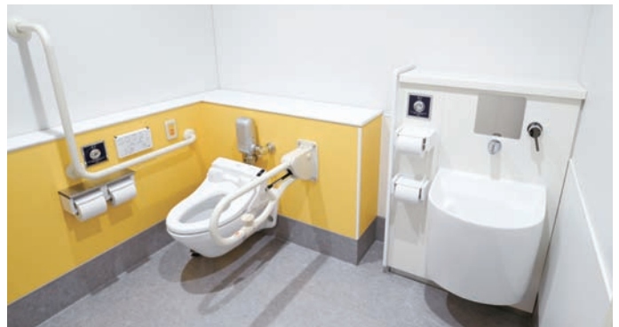
多機能トイレには、オストメイトの子どものための設備も備えられている。
