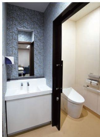
自由診療室のトイレ。意匠性の高い便器や手洗器などを採用している。
