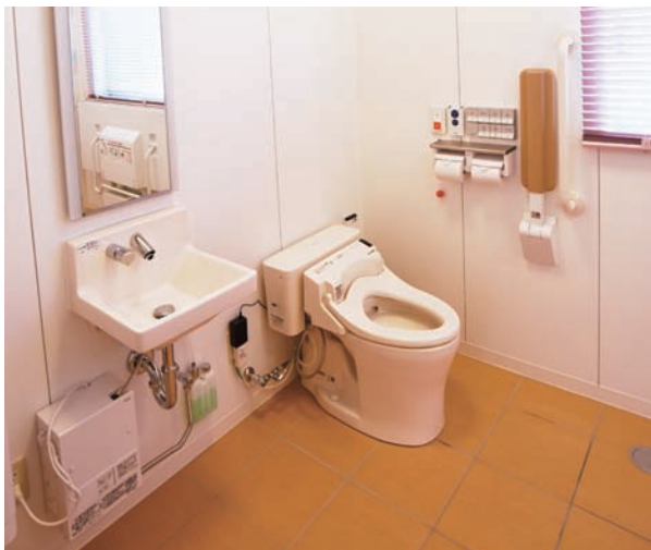
2Fに設けられた多機能トイレ。転倒のリスクを軽減し座位を保持する前方ボードや、I型手すりなどが設置されている。
