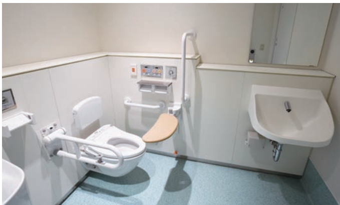
スイングタイプの前板ボードなどが備えられた3Fの多機能トイレ。入口では音声ガイドで誘導している。
