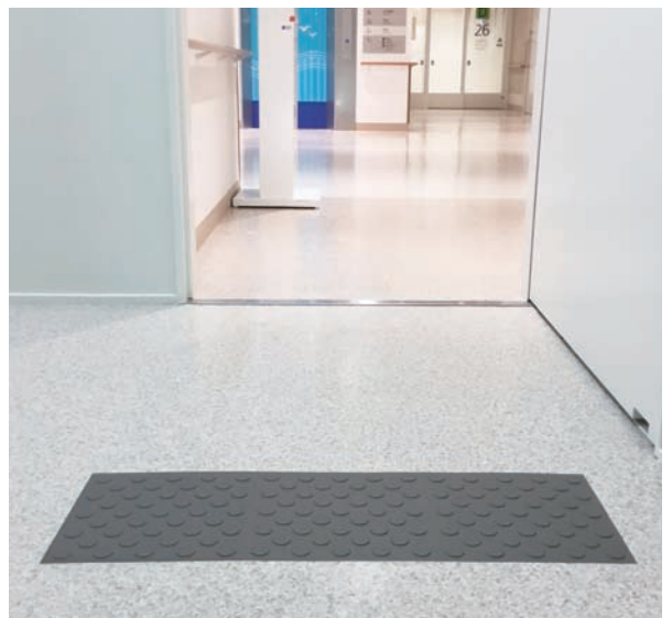
階段の手前に設けられた、屋内用の低突起の点字ブロックである「UDフロアシステム」。
