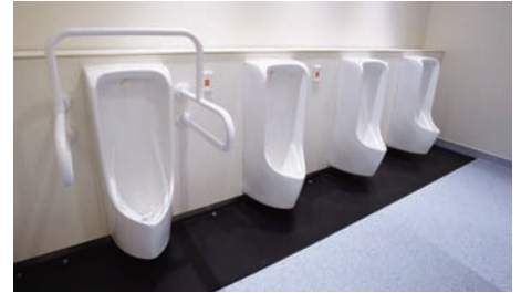
3F男性用トイレの小便器も壁掛けタイプ。防汚防臭陶板を採用している。
