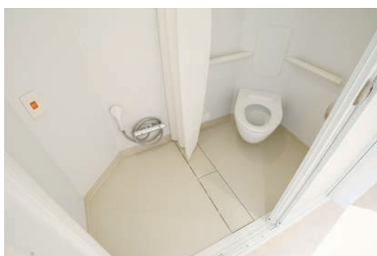
精神科病棟個室の、八角形のトイレ・シャワーユニット。万が一の事故を回避するために、シャワー金具の位置や手すりの形状に配慮している。
