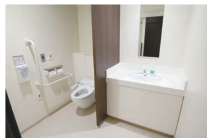
病棟の共用トイレでは、左勝手や右勝手を考慮。洗面カウンター付きのトイレも。
