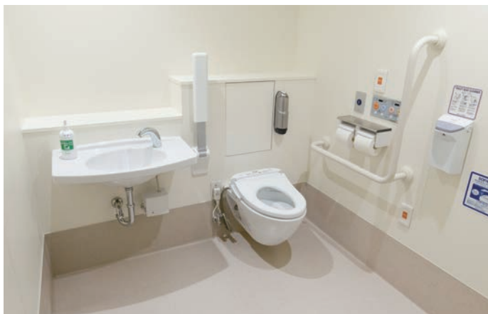
病棟の車いすトイレ。壁掛けタイプの便器やはね上げ手すり、L型手すりを採用している。
