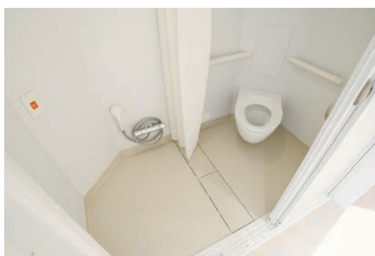
精神科病棟個室の、八角形のトイレ・シャワーユニット。万が一の事故を回避するために、シャワー金具の位置や手すりの形状に配慮している。
