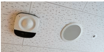
最新の見守りシステムを導入。居室の天井にセンサーを設置し、映像での確認も可能となるため、通常のナースコールとは違って緊急度が判断できる。
