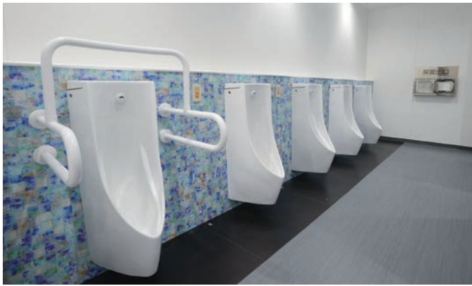
1F外来の男性用トイレの小便器。つまずき防止のため防汚防臭陶板とフロアの段差をなくしている。
