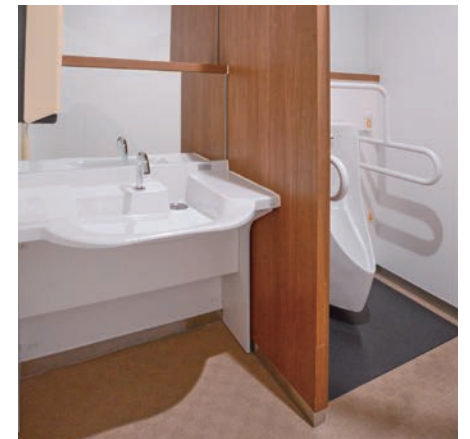
内科(脳卒中)病棟2Fの男性用車いすトイレ。感染対策にも配慮した非接触の手洗器が設けられている。
