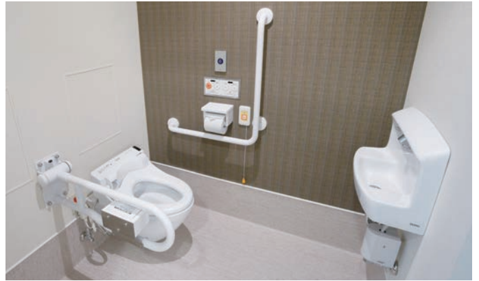
個室内のトイレには、壁掛けタイプの大便器、はね上げ手すり、L型手すりを設置。アクセントクロスによって壁と手すりのコントラストを付けている。
