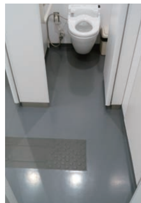
2Fトイレの大便器前まで低突起型点字ブロックが誘導しているため、ブースや便器の位置が格段に認識しやすくなった。
