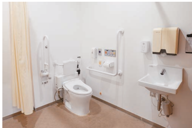
車いすトイレ内には、はね上げ手すり、L型手すり、背もたれなどが設置されている。
