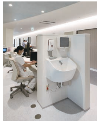
スタッフステーションの入口に設けられた、水はねの少ないスタッフ用手洗器。
