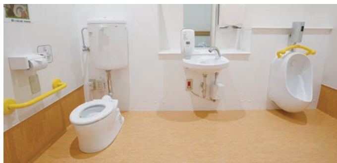
小児病棟のキッズトイレ。なお、小児科外来近くには子ども用便器を併設したファミリートイレを設置している。
