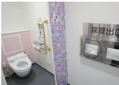
1F外来の女性用トイレ。ブースは内開きで使用状況が分かりやすく、非常時は外開きにすることができる。
