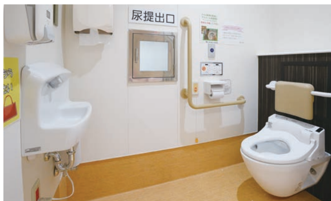
3Fの車いすトイレにはL型手すりや背もたれなどを設置。大便器は清掃のしやすい壁掛けタイプを採用している。
