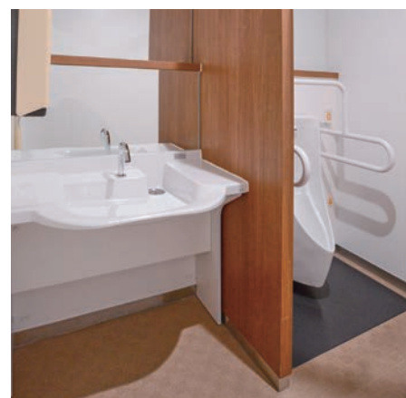
内科(脳卒中)病棟2Fの男性用車いすトイレ。感染対策にも配慮した非接触の手洗器が設けられている。
