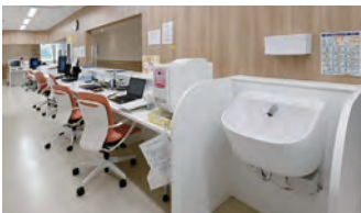
スタッフステーションの出入口に設置された、水はねの少ないスタッフ用手洗器。
