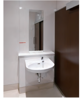
1Fデイサービスのトイレに設けられている、車いすでの利用にも配慮した手洗器。
