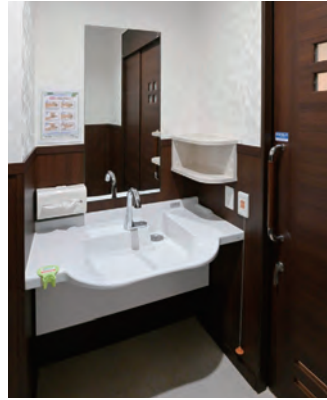
個室の手洗器。車いすで使う時期にも、回復して立って使う時期にも、どちらでも使いやすいという視点で選ばれている。
