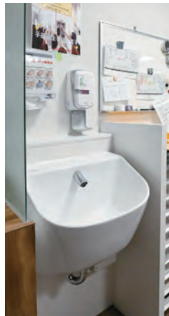
病棟のスタッフステーションの出入口に設けられたスタッフ用手洗器。
