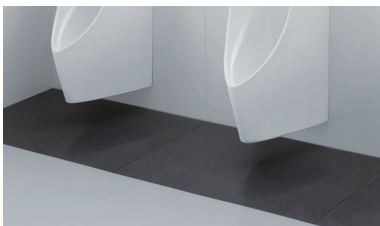
トイレ設置例
