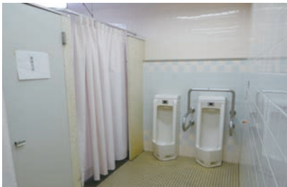
改修前の男性用トイレ。湿式であり、清掃が大変だった。
