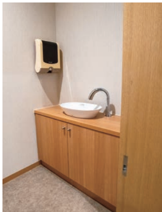
使いやすい高さを考慮した、男性用トイレの手洗い器。自動水栓が採用されている。
