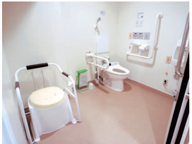
4 床室前の車いすトイレ。ポータブルトイレを置いても広々としている。
