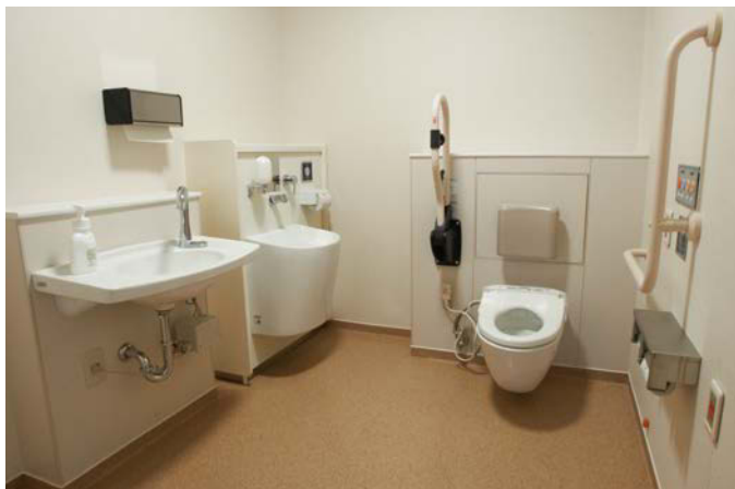
病棟のオストメイト対応の多目的トイレ。L型手すり、跳ね上げ手すりなどが設けられている。
