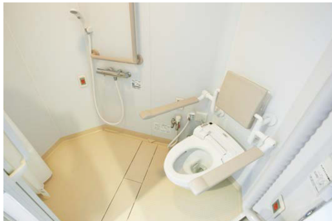
病棟個室にある8角形のトイレ・シャワーユニット。壁掛け便器で清掃のしやすい、清潔さを保てる空間となっている。便器にはシャワースズルが付いて、尿器などを洗うのにも便利である。
