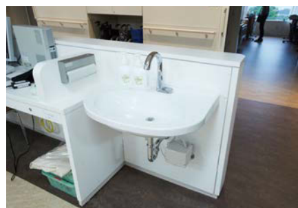
スタッフステーションの入口に設けられた手洗器。水はねが少なく、自動水栓で非接触であるため、衛生的である。
