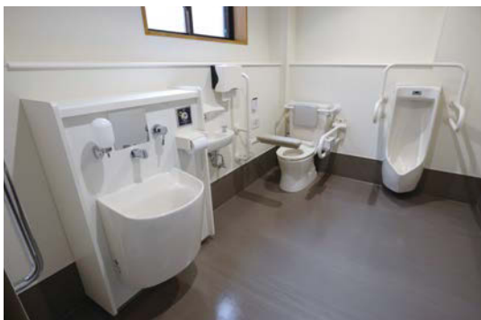
オストメイト対応の多機能トイレ。小便器での排泄を望む人にも応えられる、十分な広さを確保した空間となっている。
