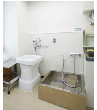
整形外科にある処置室には、汚物流しを設備。右側は、患者さんの足を洗える脚洗器。
