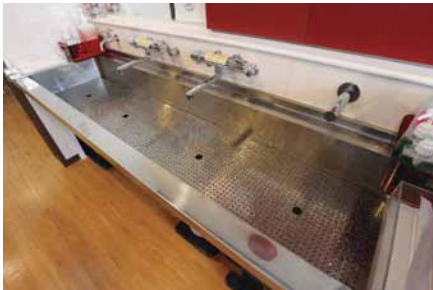
車いすでも使いやすく、使う人の状態に合わせて利用できるような、さまざまなタイプの水栓が設けられた洗面スペース。
