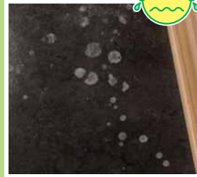
トイレに使われるワックスは、消毒液(エタノール/次亜塩素酸ナトリウム)で白化することがある。UVコーティング床材の採用で解決。
