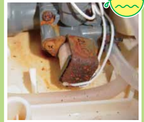
塩素濃度の高い洗剤により腐食した金属部品。薬品類は適切な濃度で使用する事が重要。
