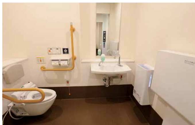
同じく外来の多機能トイレ。転倒してしまった場合でも使える位置にナースコールが設けられている。
