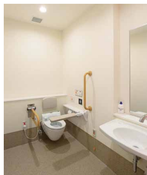
車いすトイレには、背もたれや前方アームレストなどを設置。
