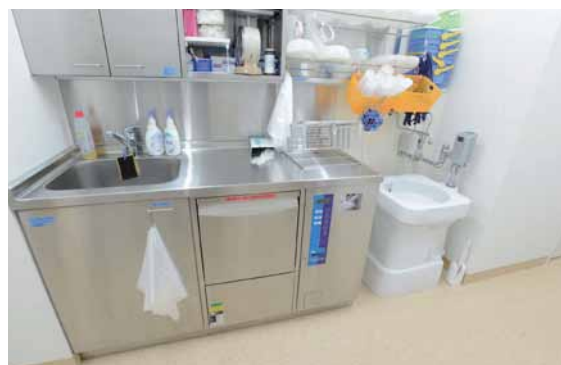
効率的に作業できるように、汚物流しなどが設置された汚物処理室。
