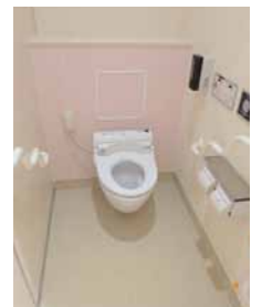
2Fの女性用トイレ。コンセントカバーが設けられている。
