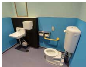
小児外来の「こどもトイレ」。子どもに合わせた設備の設置高さになっている。
