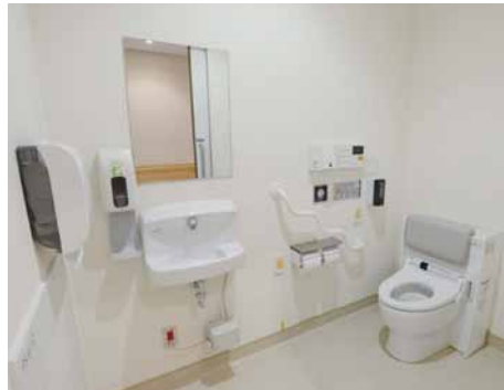
尿流量測定装置付きのトイレが、病棟の5～7Fに設けられている。
