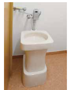
2Fに設置されたセンサー式の汚物流し。
