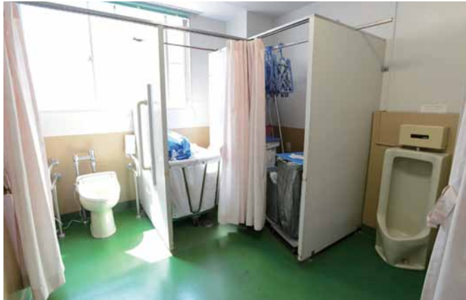
改修する前の2Fの男性用トイレ。車いすでは使いづらく、カーテンで仕切られているため、患者さんのプライバシーへの配慮が十分ではなかった。
