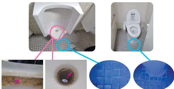
小便器 フチ裏 尿石 小便器 トラップ 尿石 小便器下(床) 尿染み 洋式便器床 尿染み
