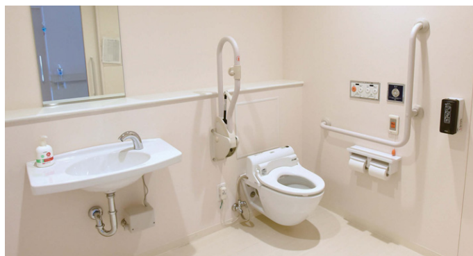
病棟10Fの車いすトイレ。便器は壁掛けタイプで、跳ね上げ手すり、L型手すりが設けられている。
