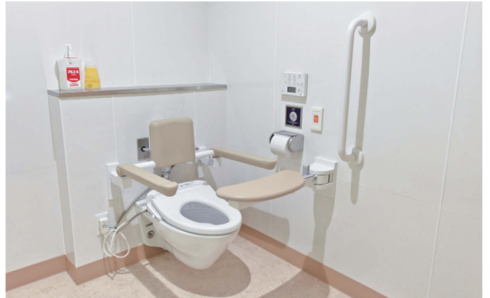
認知症居室の車いすトイレのブース内。前方ボードや背もたれ付きトイレ用手すりなどが設置されている。
