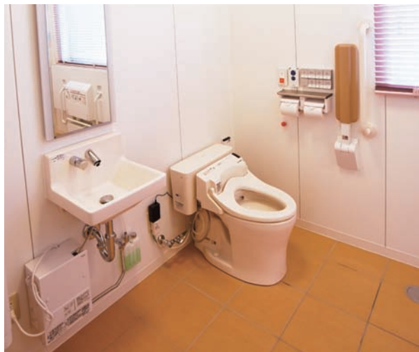
2Fに設けられた多機能トイレ。転倒のリスクを軽減し座位を保持する前方ボードや、I型手すりなどが設置されている。
