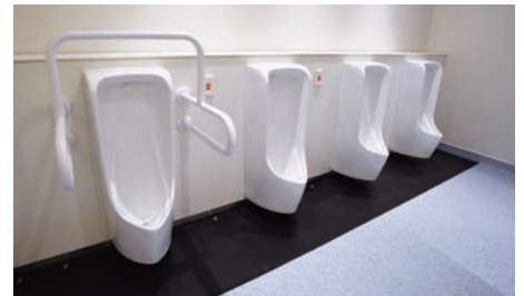
3F男性用トイレの小便器も壁掛けタイプ。防汚防臭陶板を採用している。
