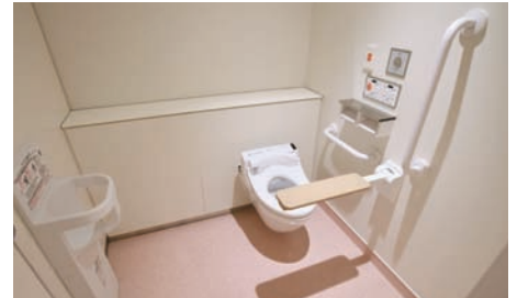
女性用トイレのブース。便器は清掃のしやすい壁掛けタイプである。
