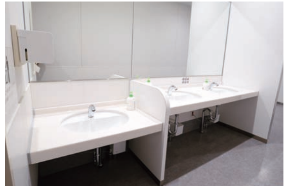
外来の女性用トイレには、誰にでも使いやすいように高さの異なる手洗器を設置。
