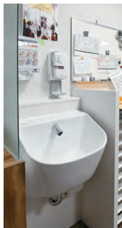
病棟のスタッフステーションの出入口に設けられたスタッフ用手洗器。
