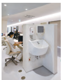
スタッフステーション 出入口の手洗器
