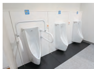
男性用トイレの小便器にも壁掛けタイプを採用しているため、清掃しやすい。
