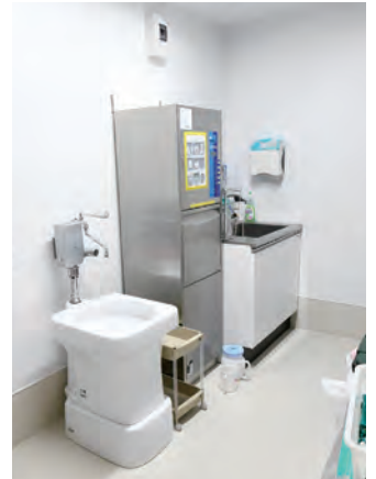
病棟の汚物室。トルネード汚物流しや、ベッドバンウォッシャーなどが設置されている。
