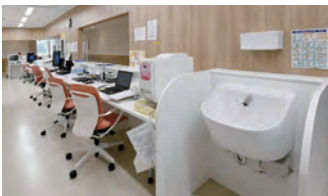
スタッフステーションの出入口に設置された、水はねの少ないスタッフ用手洗器。
