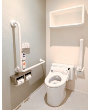
1人部屋のトイレには、コンパクトな掃除口付きの大便器を採用している。
