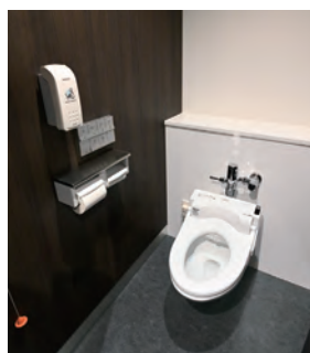
4Fのスタッフ用トイレ。大便器は清掃のしやすい壁掛けタイプである。
