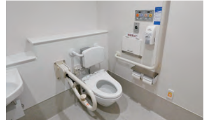
検尿用の車いすトイレでは、便座に座ったまま検尿提出口にカップを入れられる。提出口の扉にマグネットを使うと開けた時にバランスを崩す人もいるので、引き扉にした。
