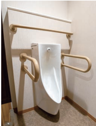
男性用トイレの小便器は手すり付きで使いやすい、壁掛けタイプで清掃しやすい。
