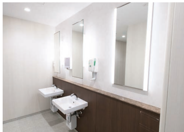
4Fのスタッフエリアの女性用トイレには、スタイリングコーナーを新設。非接触で節水にもつながらる自動水栓を採用し、鏡の後ろに照明を設置して明るい空間にしている。
