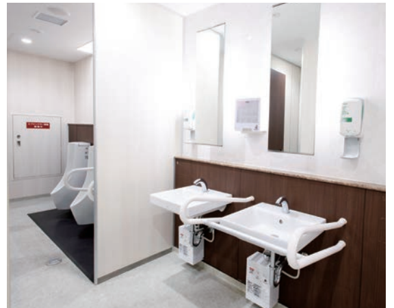
中央診療棟5Fの男性用トイレ。自動洗浄小便器や自動水栓など、非接触の設備を採用。また冬場でも快適に使えるよう、小型電気温水器も設置されている。
