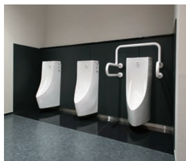
男性用トイレの自動洗浄小便器。汚れやすい床面の清掃性に配慮して、壁掛けタイプを採用している。
