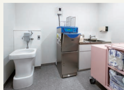
病棟の汚物処理室。ベッドバンウォッシャーやシンクがあり、汚物流しは肘でも操作できるレバーハンドル式で使いやすい。清潔と不潔のゾーニングがしっかりできるようになった。
