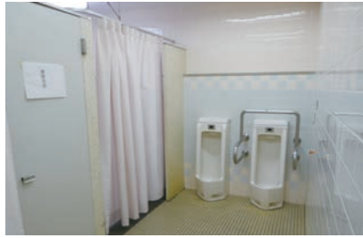
改修前の男性用トイレ。湿式であり、清掃が大変だった。
