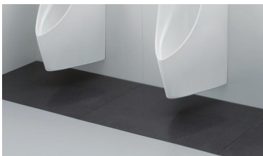
トイレ設置例
