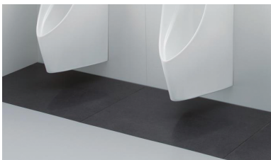
トイレ設置例
