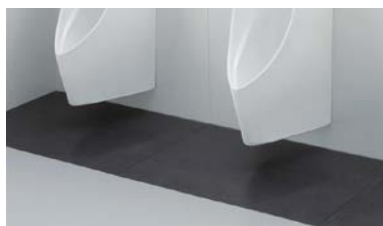
トイレ設置例
