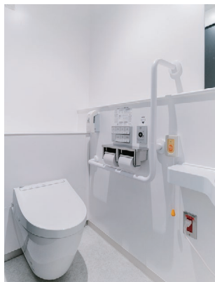
オールジェンダートイレの個室。ベビーチェア付きとフィッティングボード付きがそれぞれ用意されている。
